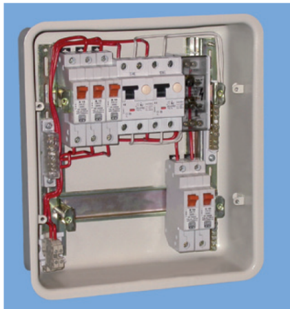
Chasis Porta Interruptor instalado en caja.
